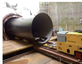
シールド工法による大容量送水管の整備(鋳鉄管の配管)
