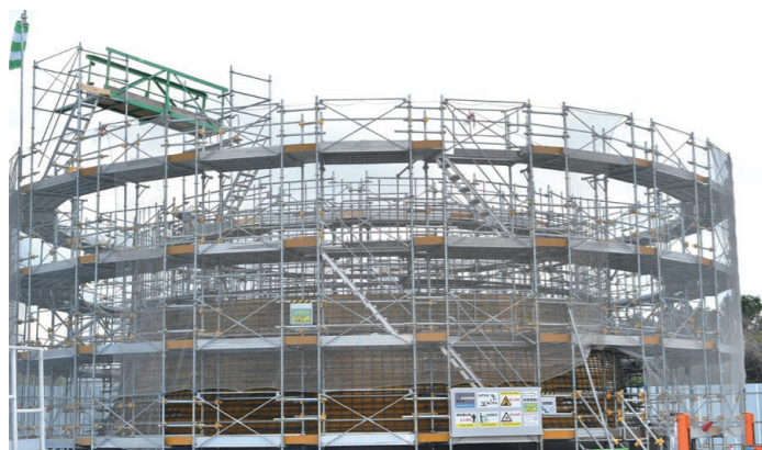
災害に対する安全性の強化のためのバイパス配水管の整備(立坑の築造)
