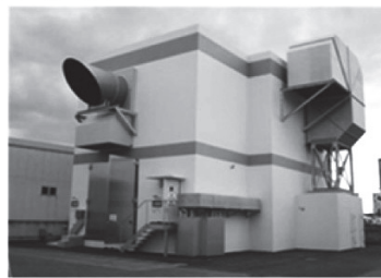
非常用自家発電施設の整備 (停電対策)
