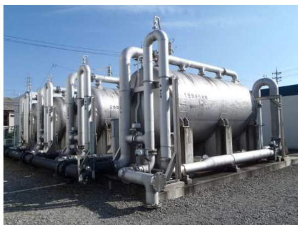
【除鉄・除マンガ ン設備】
