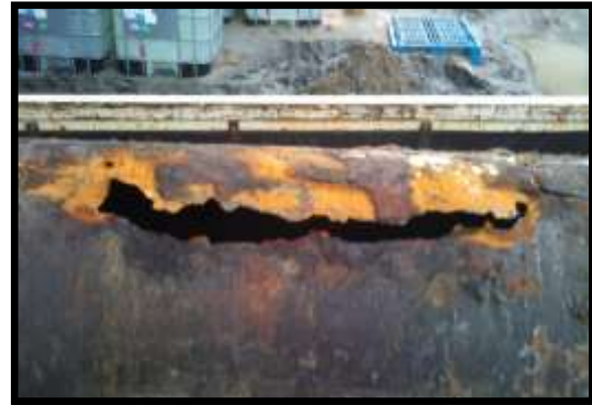
破損した老朽管
