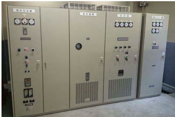
図-5.2.1 さくら坂低区配水池 受変電設備・計装設備
