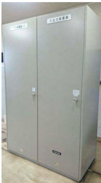
図-5.2.3 一須賀浄水場中央監視 運転装置（制御盤）
