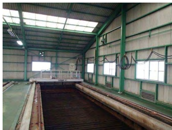
図-2.2.5 急速ろ過池
