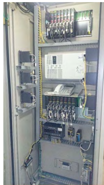
図-5.2.4 一須賀浄水場中央監視 運転装置（制御盤内部）
