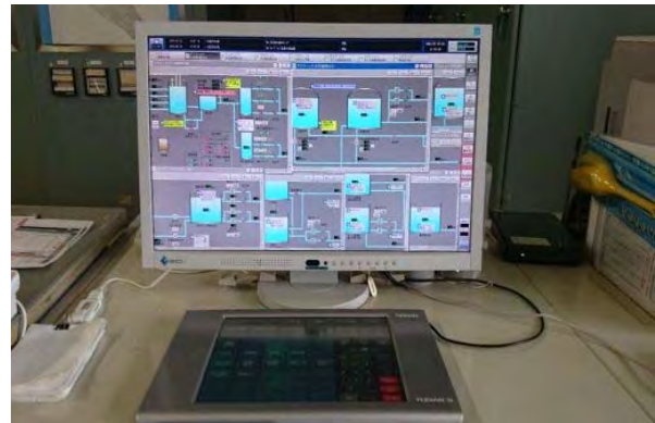
図-5.2.2 一須賀浄水場中央監視 運転装置（操作画面）
