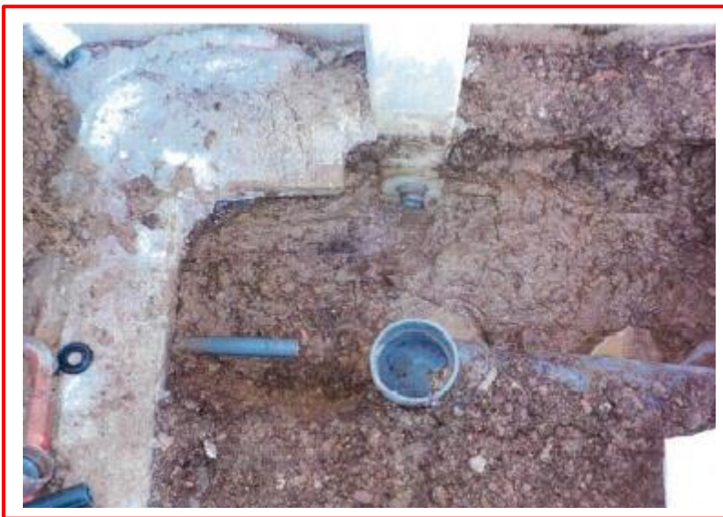
○修繕前（漏水箇所）
