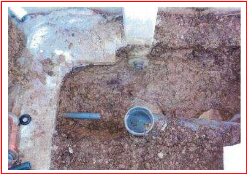
○修繕前（漏水箇所）
