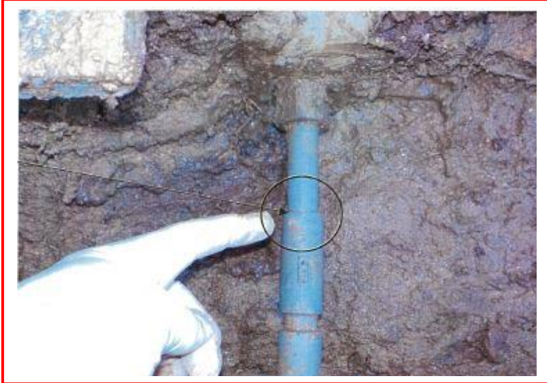
○修繕前（漏水箇所）
