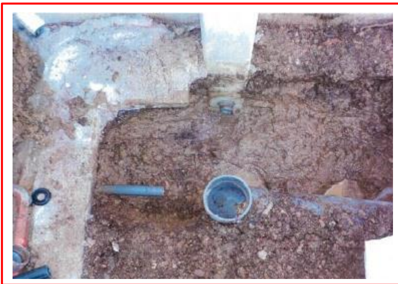
○修繕前（漏水箇所）
