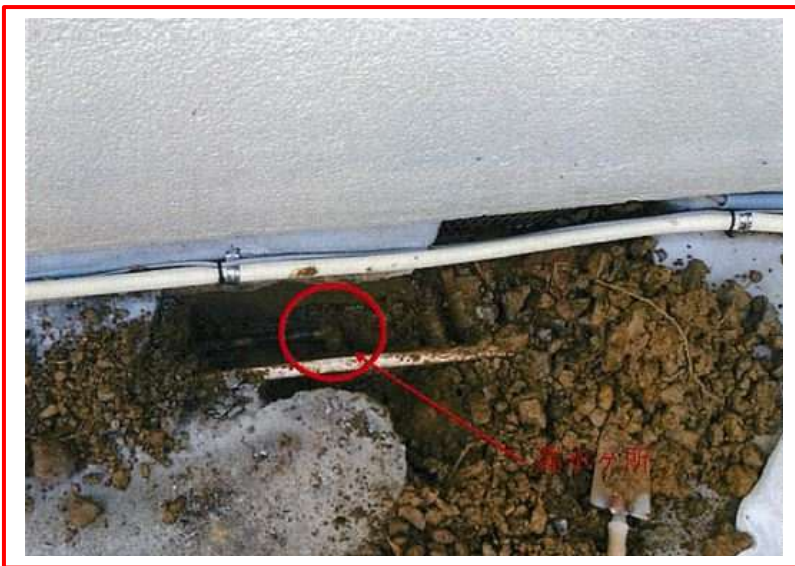
○修繕前（漏水箇所）
