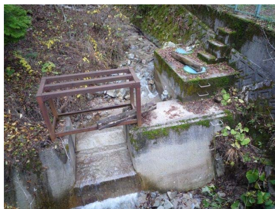
千早第2水源地
