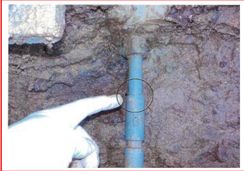
○修繕前（漏水箇所）
