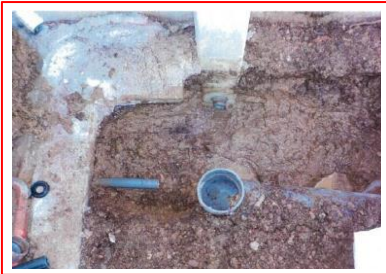
○修繕前（漏水箇所）
