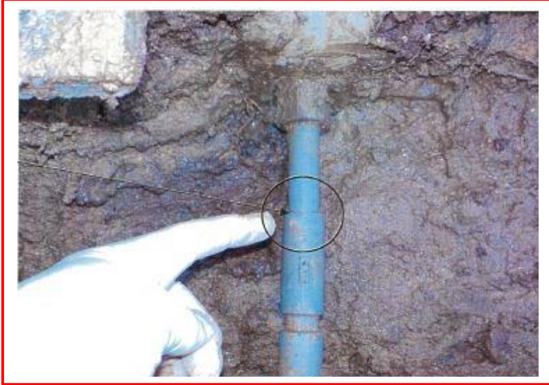
○修繕前（漏水箇所）
