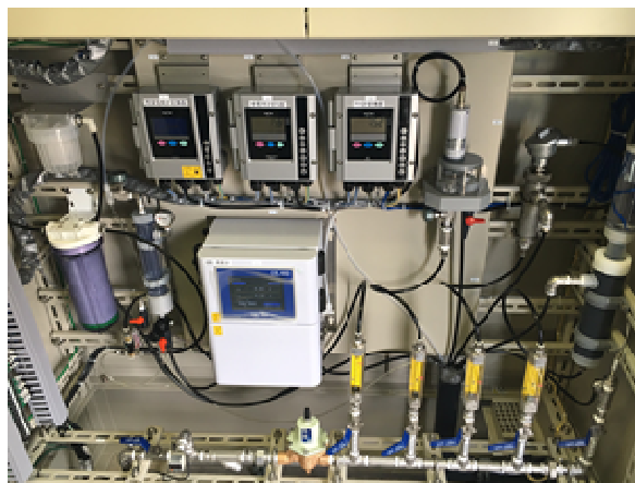
図-10 連続自動測定機器（水質モニター）
