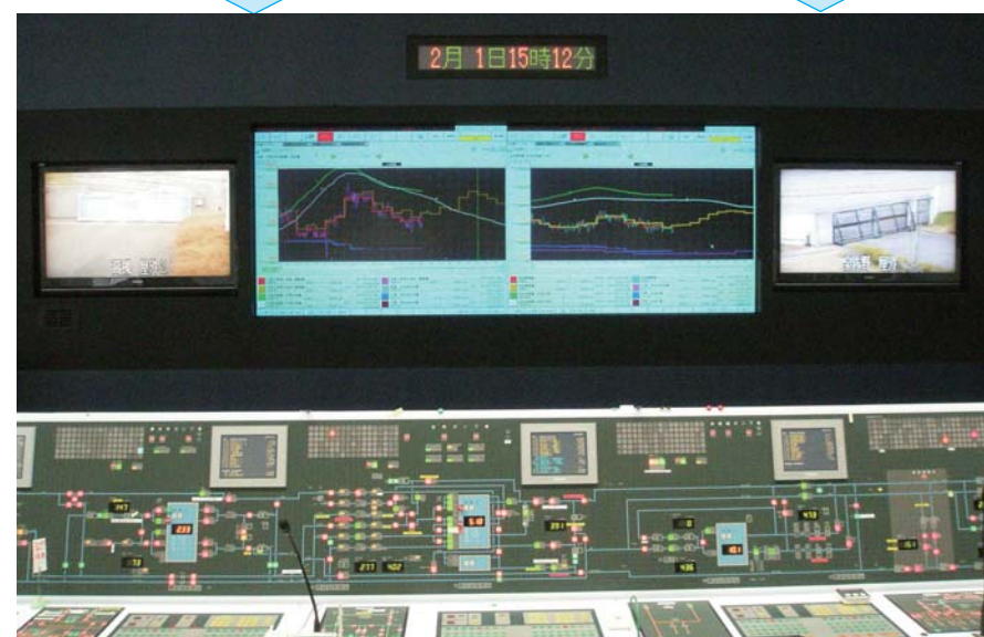
プロジェクター、ミニグラフィック監視操作卓
