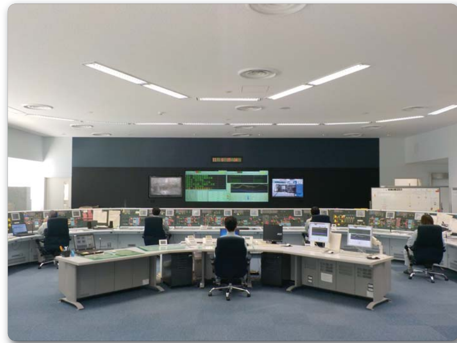
送水管理センター 中央管理室
