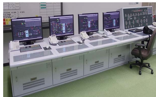
送水管理サブセンター（村野浄水場）
