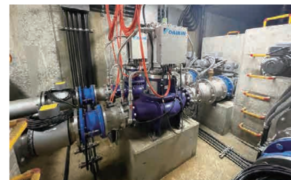
小水力発電設備
