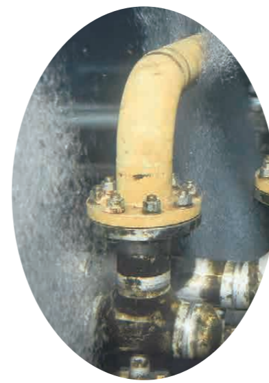
オゾン接触池
