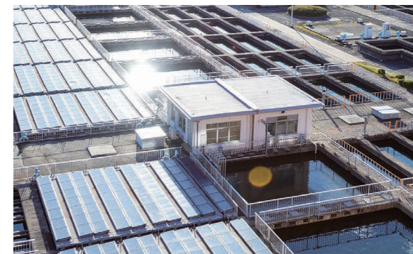
太陽光発電設備
