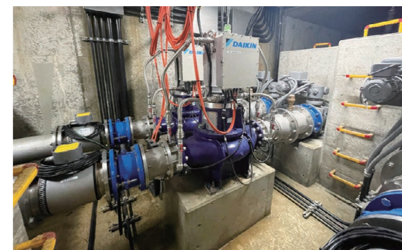
小水力発電設備
