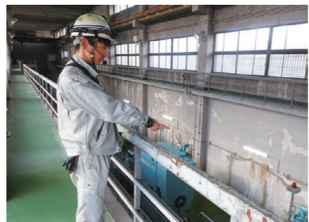
工業用水道施設における維持管理
