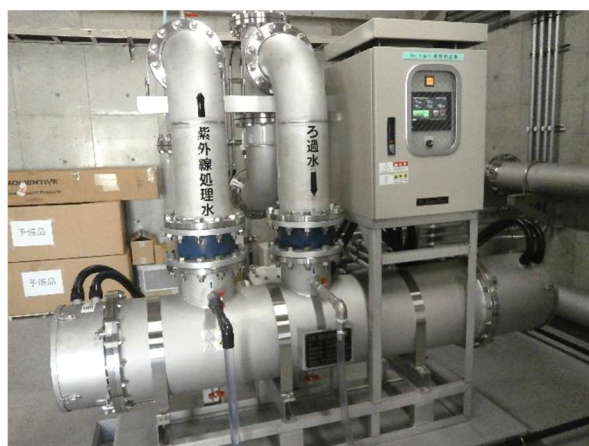
紫外線処理設備
