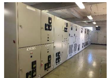
高圧電気設備
