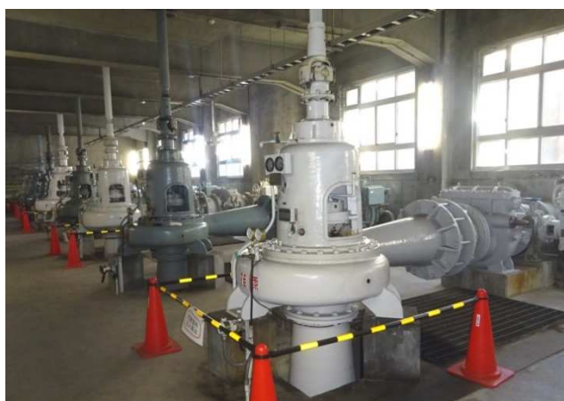
配水ポンプ設備（既設）
