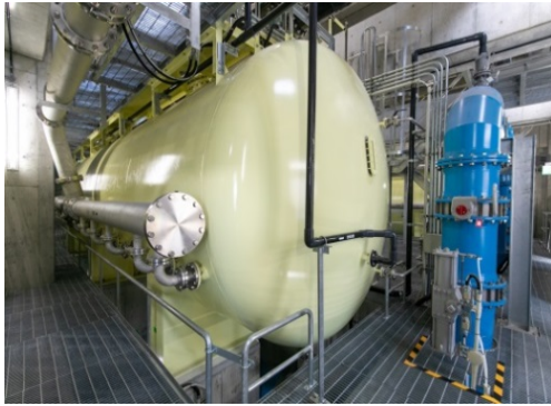
▲庭窪浄水場 後ろ過機
