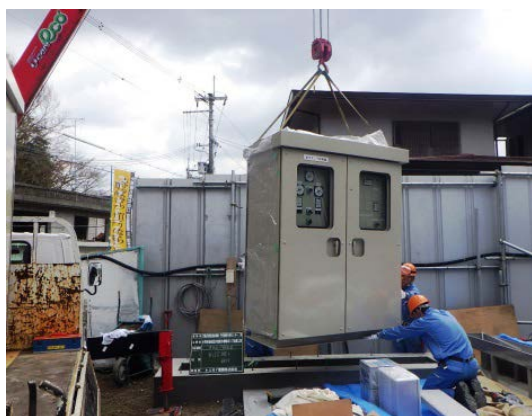
▲電気計装設備
