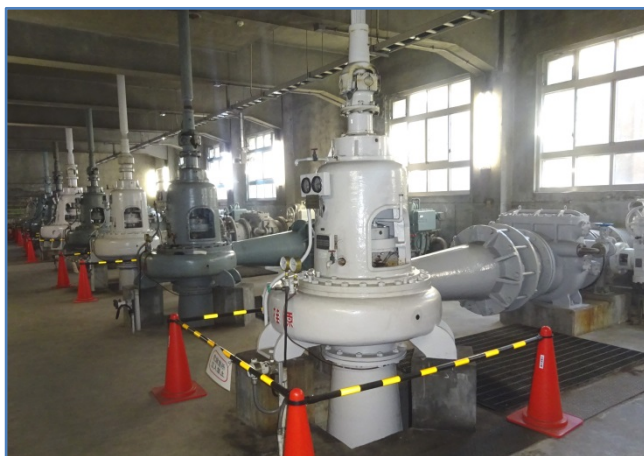
大庭配水ポンプ(既設)
