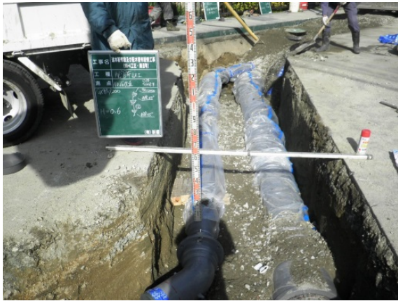
▲送水管及び配水管
