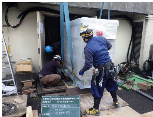
▲非常用自家発電設備
