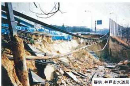
大震災における水道施設の被害状況
