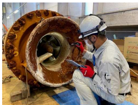
既設ポンプ インペラーの摩耗状態を確認
